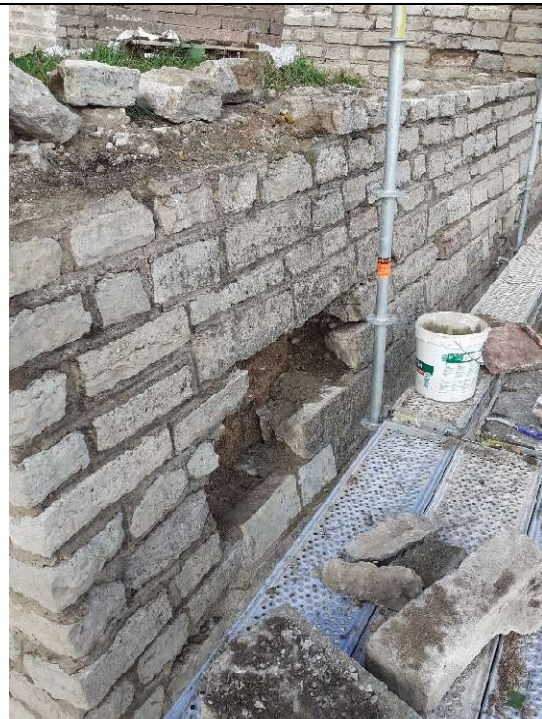
Foto 4 – Väljakukkunud kivide asendamine
